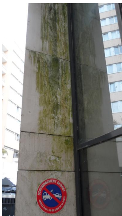
Photo 6 : une tour d'accès jamais nettoyée
